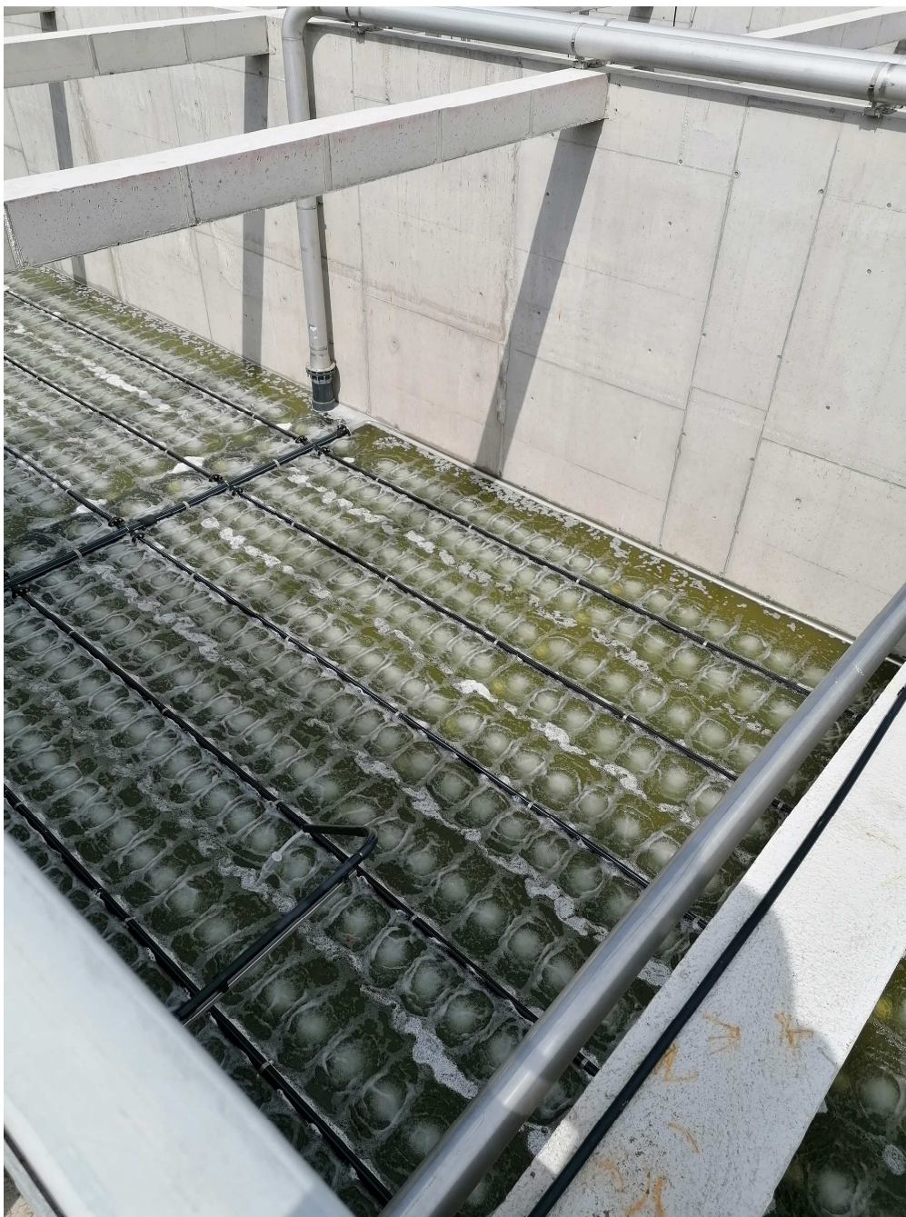
3. ábra: A szennyvíztelep próbaüzeme (forrás: saját kép)
