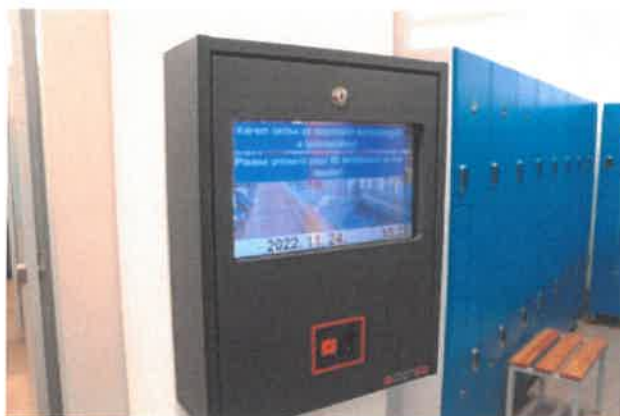
IV-2. ábra Öltözőszekrények elektronikus vezérlése
